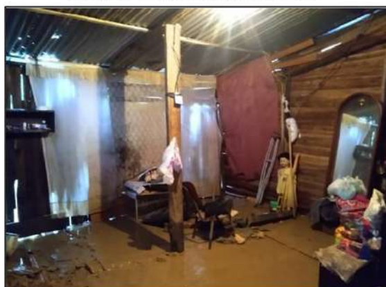
Imagen 15. Afectación en hogares
